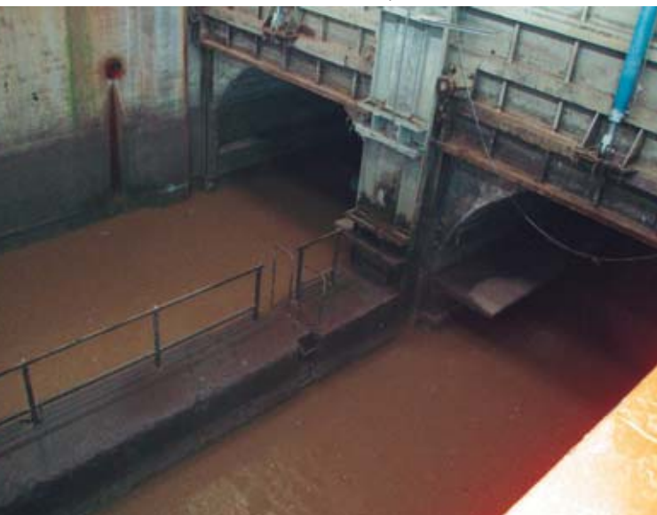
Ulaz sirove otpadne vode
